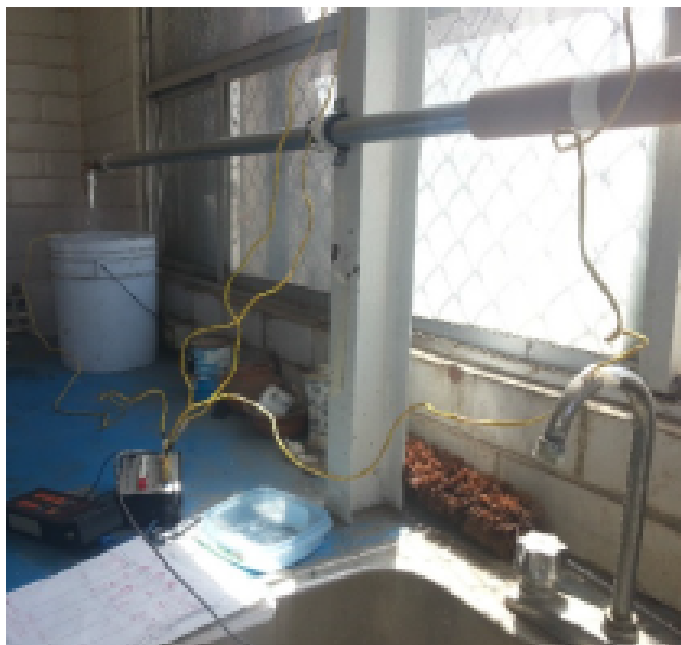
Figura 14.1: Tubería de acero galvanizado, parcialmente recubierta con un aislante térmico.
